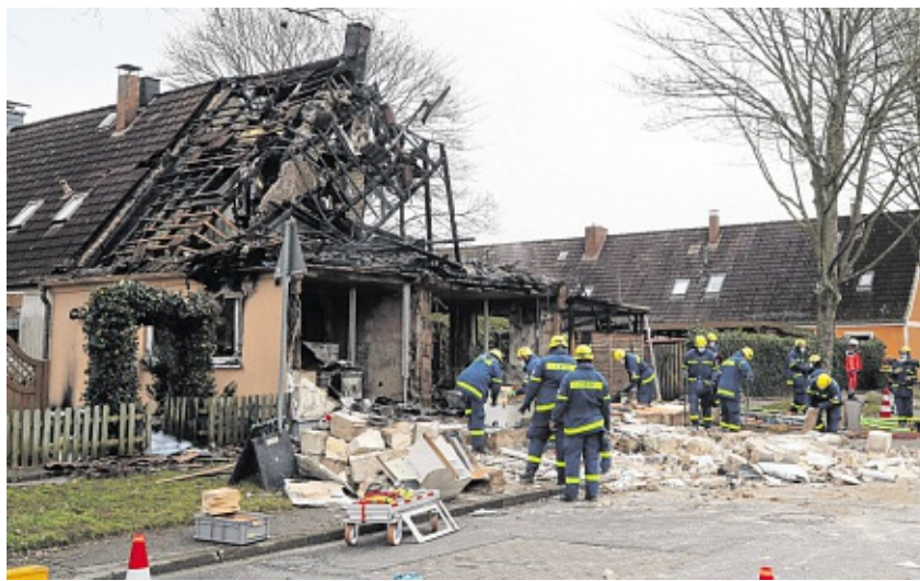
Zwei Bergungsgruppen des THW sicherten das Gebäude und räumten Trümmer weg.
